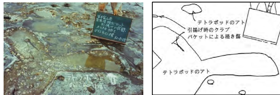
図-6 アスファルトマット上の消波ブロックの痕跡
