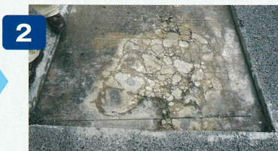
コンクリート破損面
