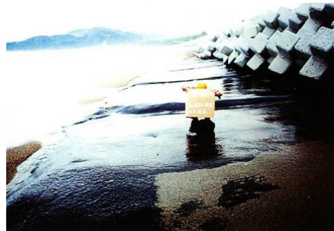
台風により露出した As マット（H4年調査）
