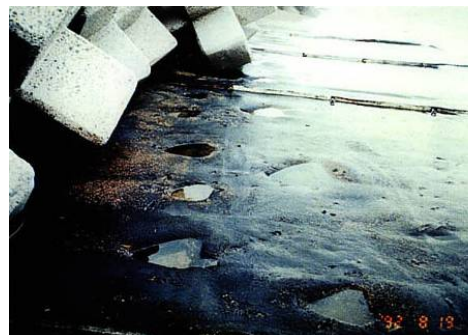
台風後の As マット状況（H4年調査）
