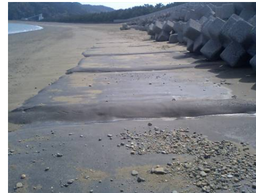
既設 As マット状況 15年経過 （H3年施工，H18年調査）
