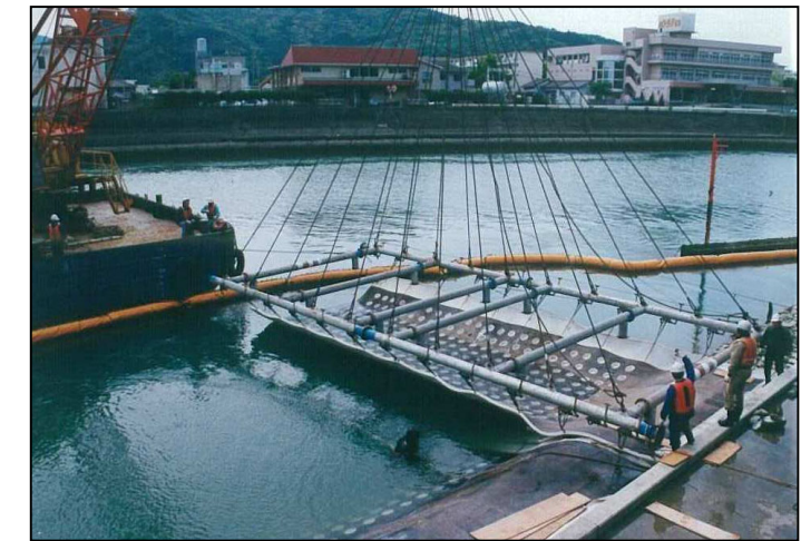
フィルターシート付 孔あきアスファルトマット敷設状況 (アスファルトマット上面)
