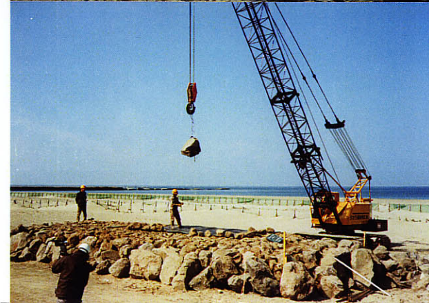
写真-3 捨石の落下状況
