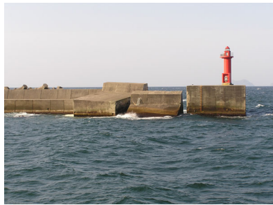
高波浪によるケーソン式防波堤の被災状況
