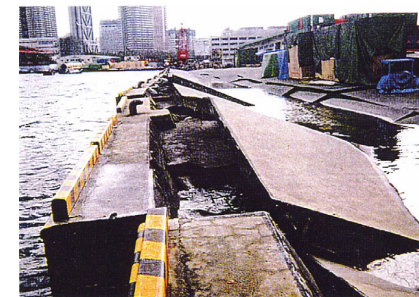
地震によるケーソン岸壁の被災状況
